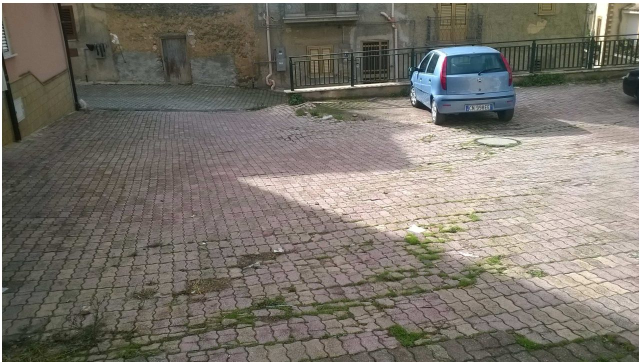
Figura 4 – Condizioni precarie della pavimentazione. Dissesti diffusi quali ormaie, buche ed avvallamenti.
