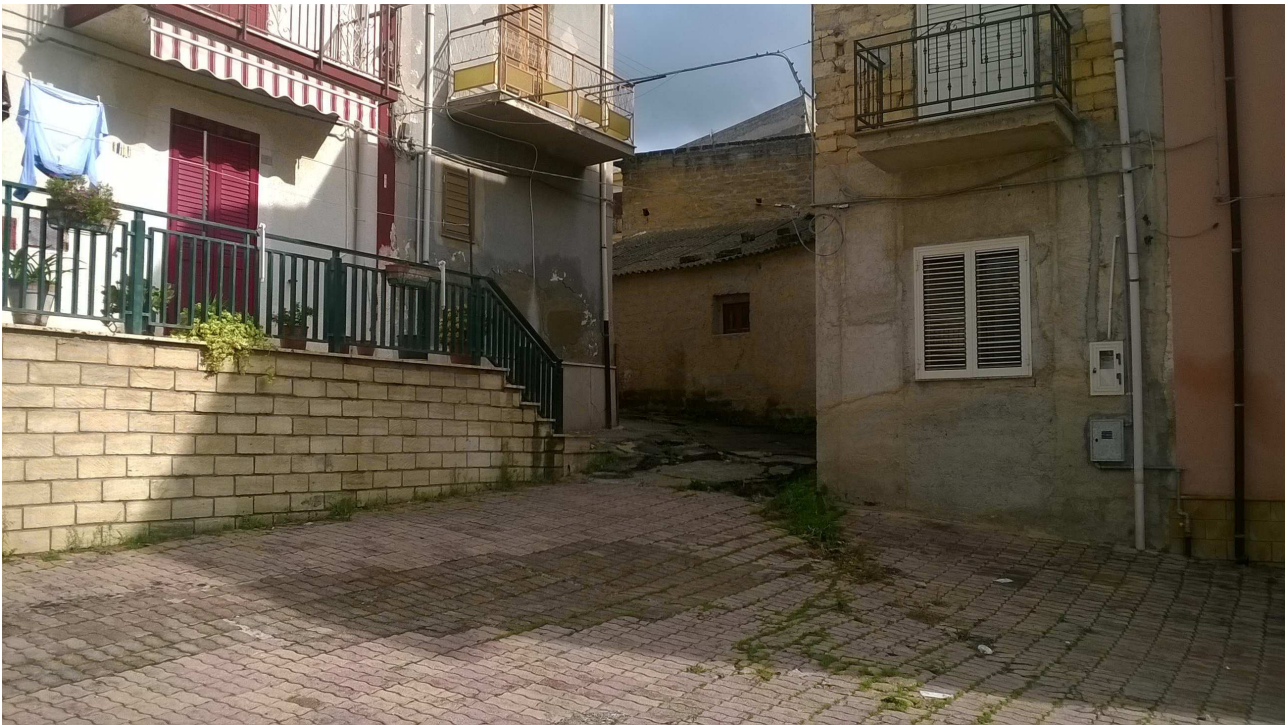
Figura 5 – nella foto si vedono chiaramente degli interventi di ripristino della pavimentazione. Oggi, viste le pessime condizioni della pavimentazione si necessita un intervento totale su tutta la pavimentazione.
