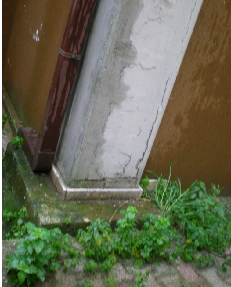
Fig. 7 – Carbonatazione della calcestruzzo del pilastro d'angolo della palestra.
