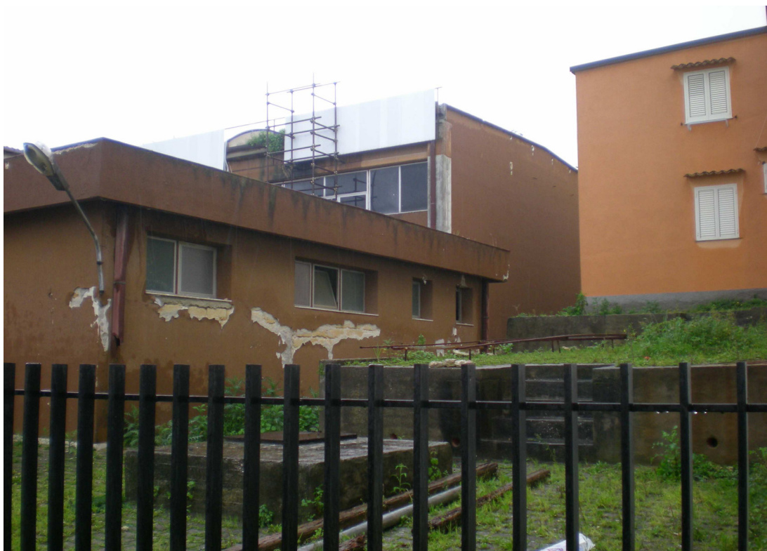
Fig. 3 – Vista laterale blocco servizi – ammaloramenti diffusi dell'intonaco
