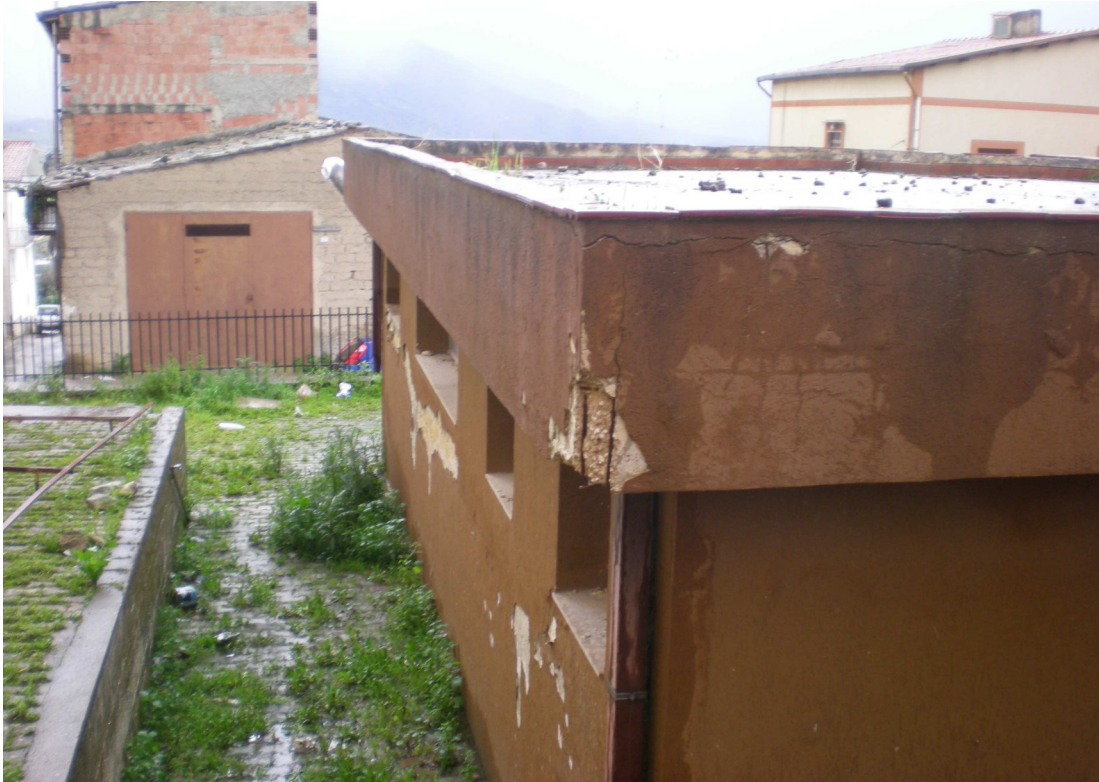
Fig. 5 – Distacco della malta copriferro per carbonatazione del calcestruzzo
