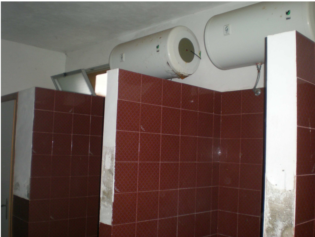
Fig. 14 – Vecchio sistema di produzione acqua calda sanitaria
