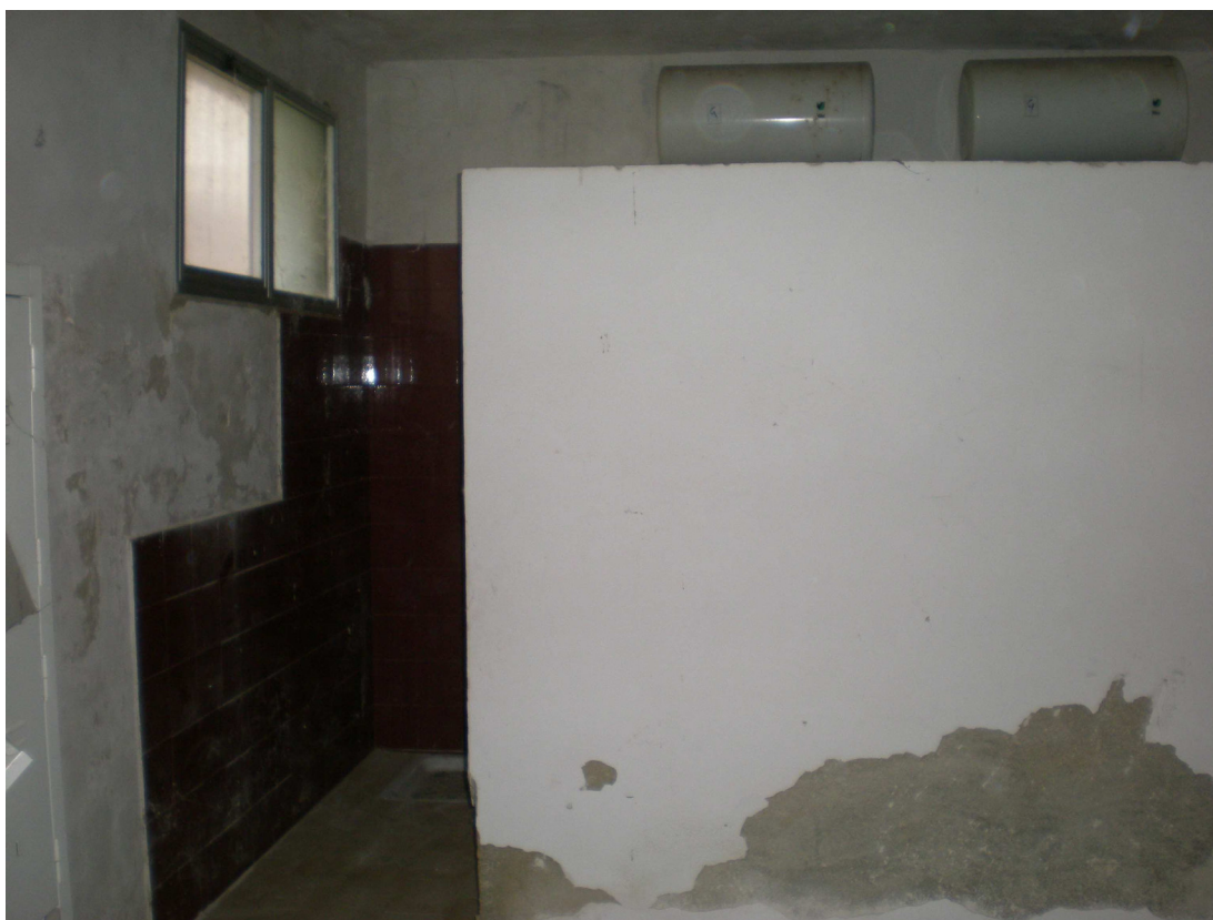
Fig. 9 – Ammaloramenti diffusi dell'intonaco degli spogliatori
