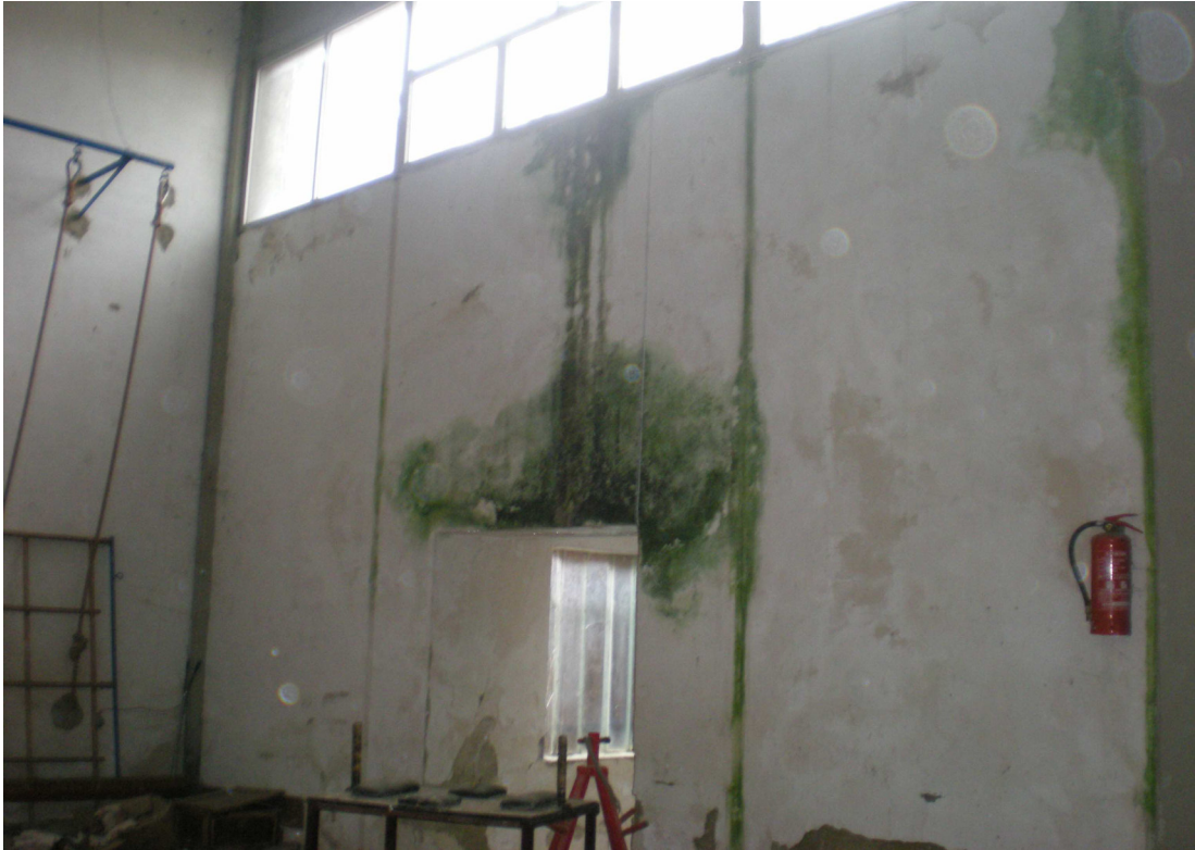
Fig. 13 – Ammaloramento delle finiture a causa dell'infiltrazioni meteoriche
