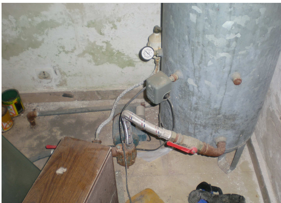
Fig. 16 – Resti del vecchio gruppo di pressurizzazione
