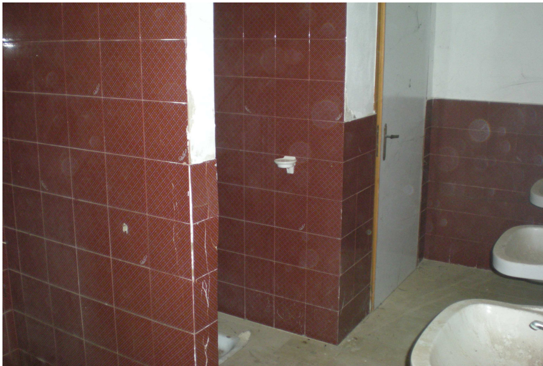
Fig. 8 – Stato fatiscente delle finiture degli spogliatoi
