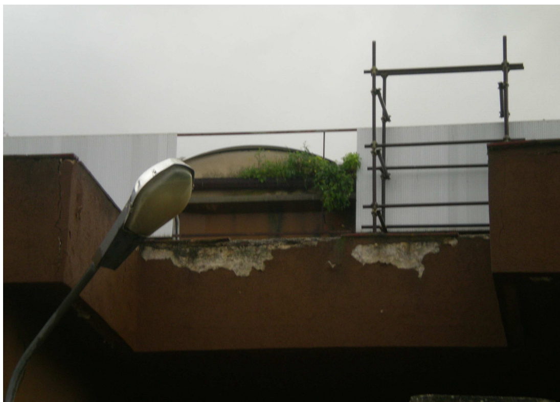
Fig. 2 – Particolare ammaloramento mantovana perimetrale.
