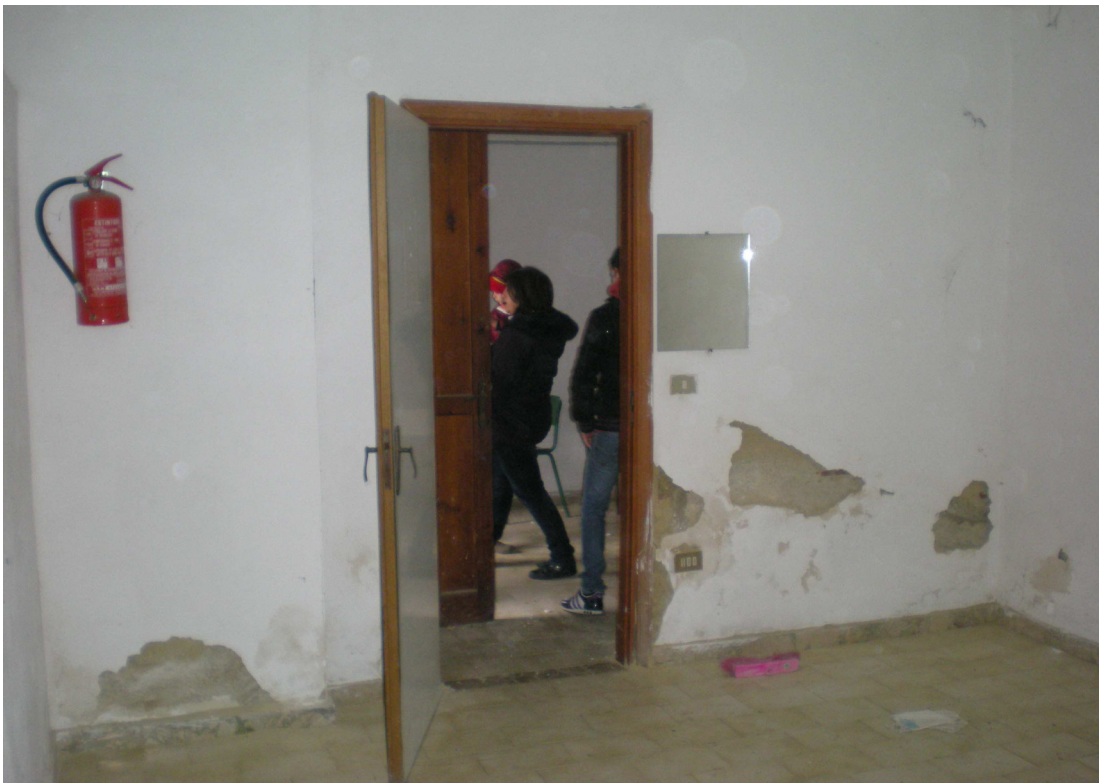
Fig. 6 – Ammaloramento diffuso dell'intonaco interno
